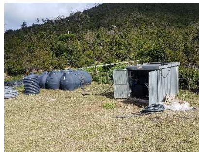
Foto del locale tecnico (provvisorio)
