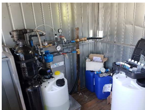
Vista laterale dello skid
